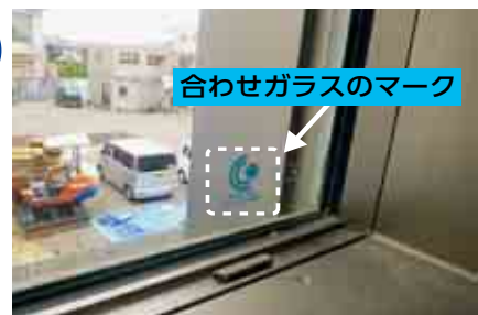
合わせガラスのマーク 飛散防止フィルム付きの強化ガラス (港南中学校屋内運動場)
