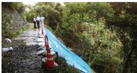
道路災害の様子（双海町池窪朝ヶ峠線）
