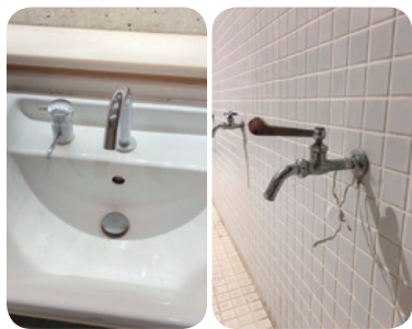
自動式蛇口(写真左)とレバー式蛇口(写真右)：港南中学校
