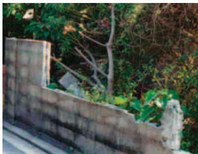
破損したブロック塀
