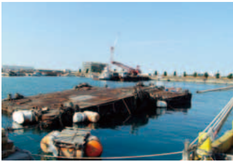
伊予漁協裏の使用不能浮棧橋
