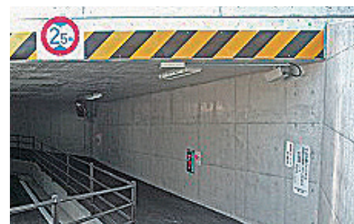
地下道に設置された防犯カメラ
