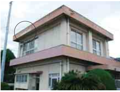
外壁が落下して改修が必要な集会所
