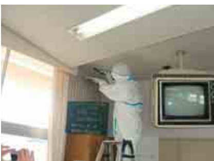
中山小学校音楽室のアスベスト調査
