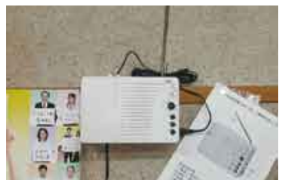
宮下音地集会所に設置された戸別受信機
