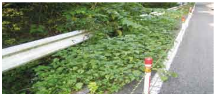
危険杭とロープのみ設置された中山の県道
