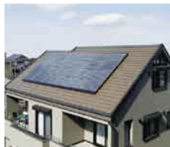
太陽光パネル
