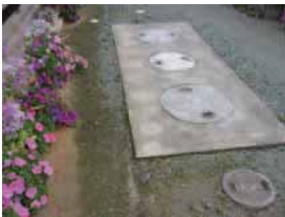
埋設してある合併処理浄化槽
