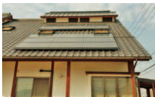
屋根に設置した太陽光パネル
