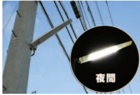
尾崎に新設されたLED防犯灯
