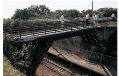
修繕が必要な橋梁 (双海地区高野川橋)
