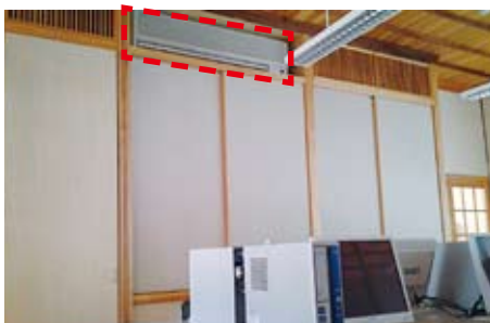
パソコン教室に設置されているエアコン
