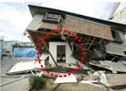
倒壊実験後の耐震シェルターの外観
