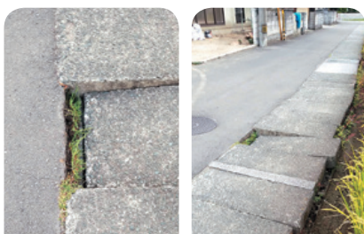
市道浜田松本線の破損箇所。これまではその都度部分改修で対応していたが、老朽化が著しいため全面改修が望まれる。
