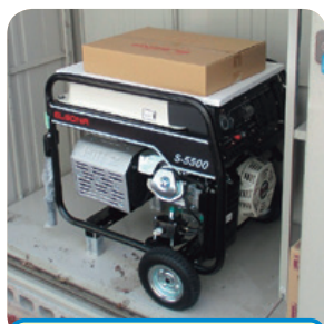
主要な指定避難所へ配備したハイブリッド式発電機
