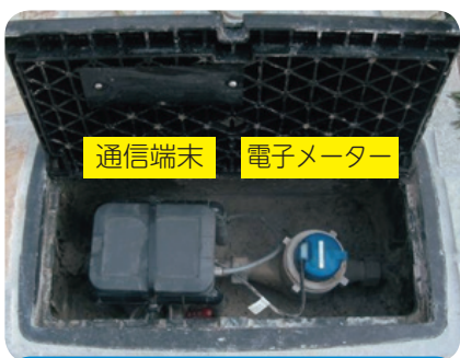
スマート水道メーターの全景
