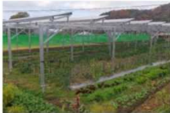
発電設備の外観
