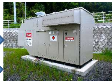
防災用自家発電装置
