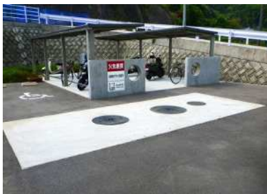
軽油地下タンク貯蔵所
