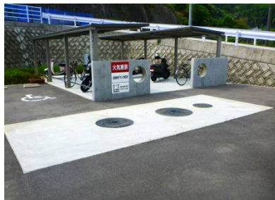
軽油地下タンク貯蔵所
