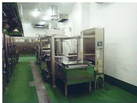
揚物・焼物・蒸し物調理室
