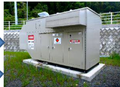
防災用自家発電装置
