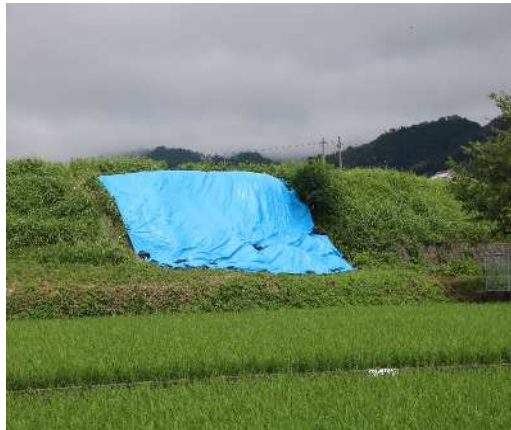
【本郡池（応急処置）】 ※中村地区公民館から見た様子
