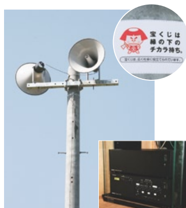
▲有線放送設備
